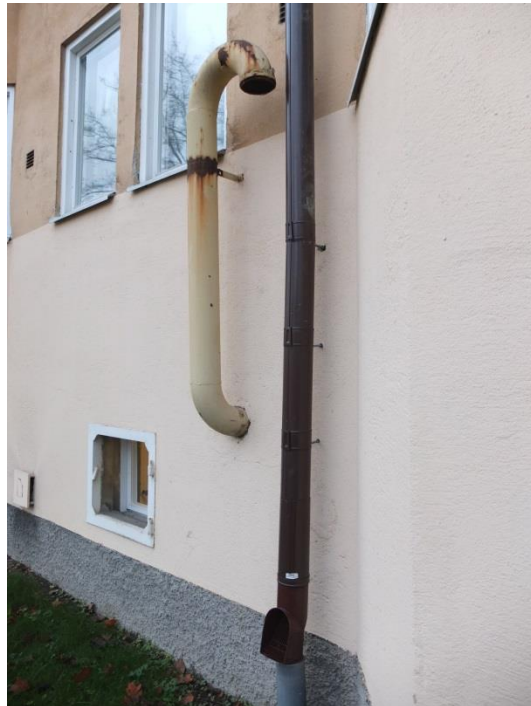
Avluftningsrör i gjutjärn och stuprör.
