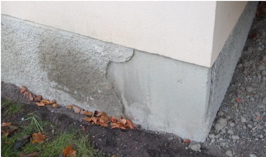
Under spritputsen döljer sig betongsockeln.
