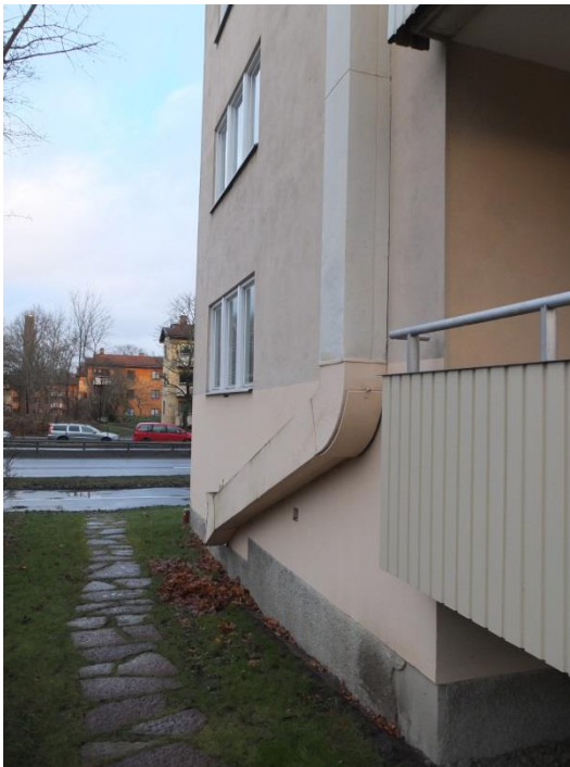
Ventilationskanal på västra gaveln.
