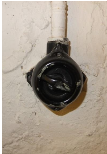
Strömbrytare i bakelit i källaren
