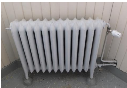
Radiator på fötter i källarutrymme.
